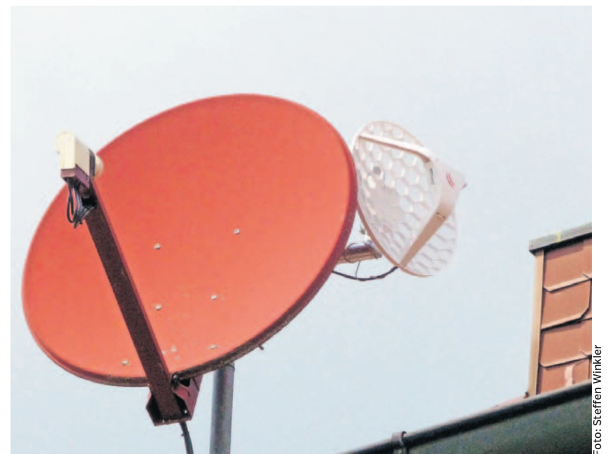
Steffen Winkler betreibt auf seinem Haus in Burk diese Richtfunkantenne für mobiles Internet. Sie ist an der Satellitenantenne befestigt und zur Stadtmitte ausgerichtet.
